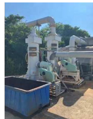
〈排ガス処理施設〉
